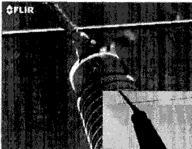
Теч на SF 6 от агулката на газове прекъсвач
