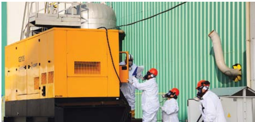
Подвързване на мобилен дизелгенератор към 5 блок
