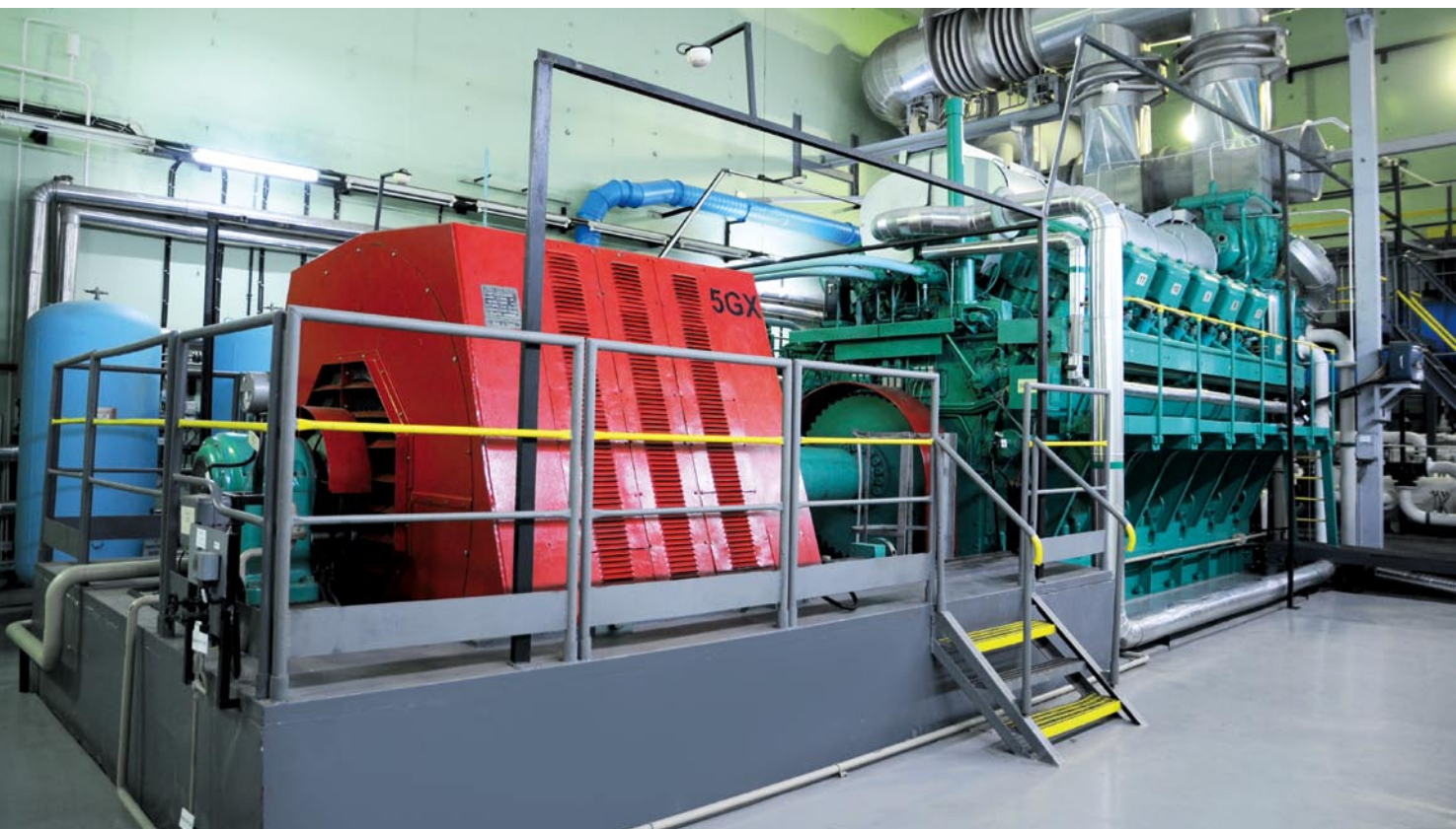
Дизелгенератор 5GX от III канал на Системата за безопасност на 5 блок
