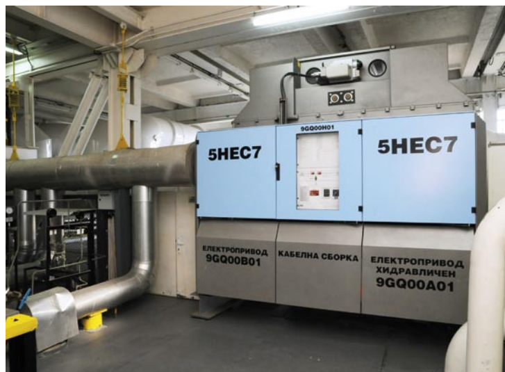
Генераторен прекъсвач на 5 блок
