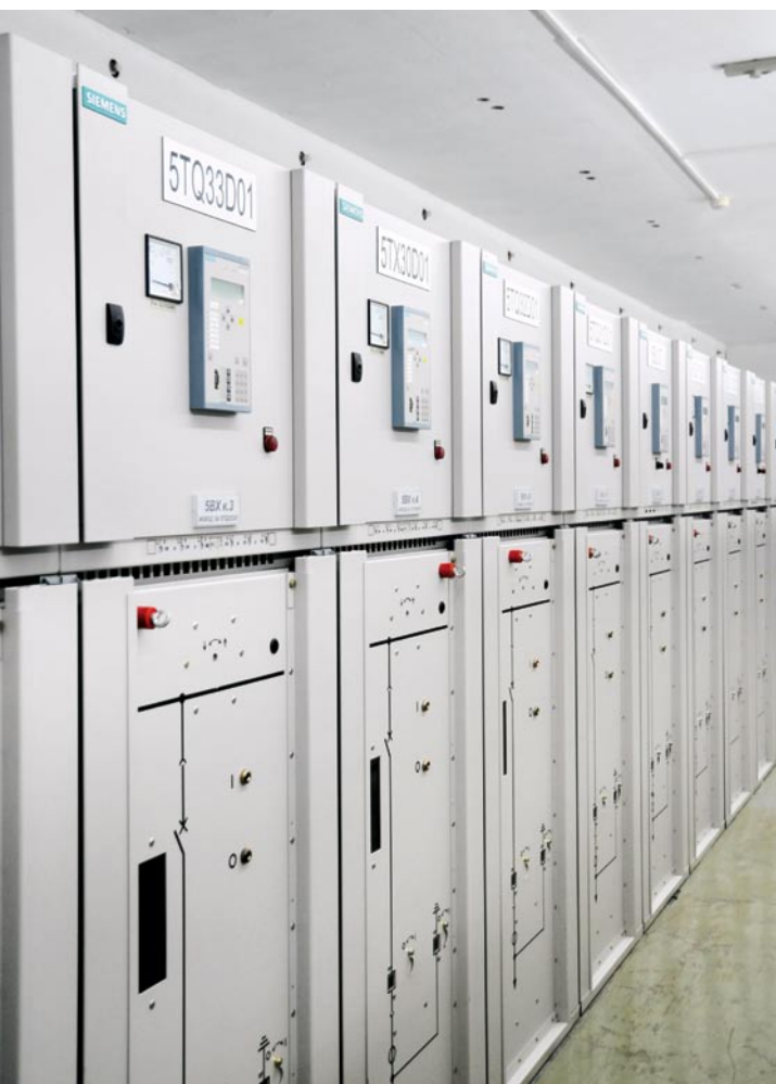
Комплексна разпределителна уредба 6 kV от III канал на Системата за безопасност на 5 блок
