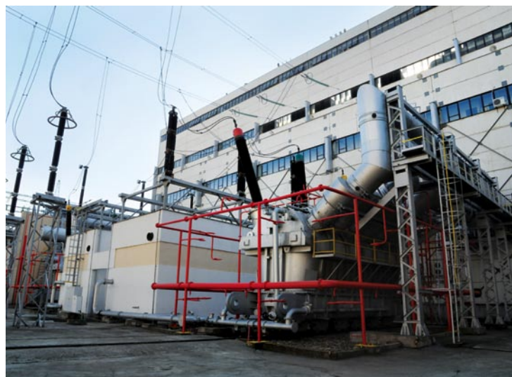
Трансформатори 400/24 kV 10GC01,02
