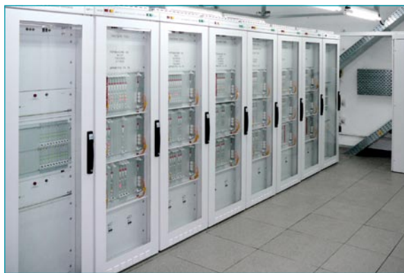
Панели за управление на новия ПТК-УСБ на първа система за безопасност на 6 блок
