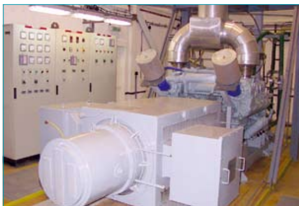
Аварийен дизелгенератор на Допълнителната система за аварийно подпитаване на парогенераторите
