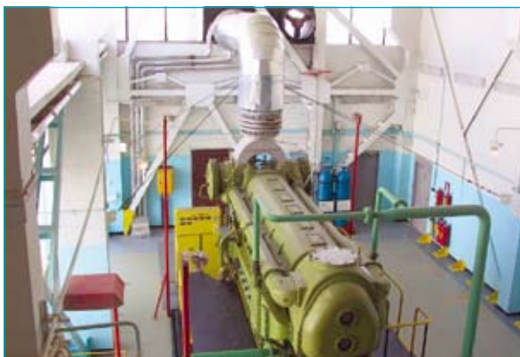
Дизелгенератор в Дизелгенераторна станция - 2
