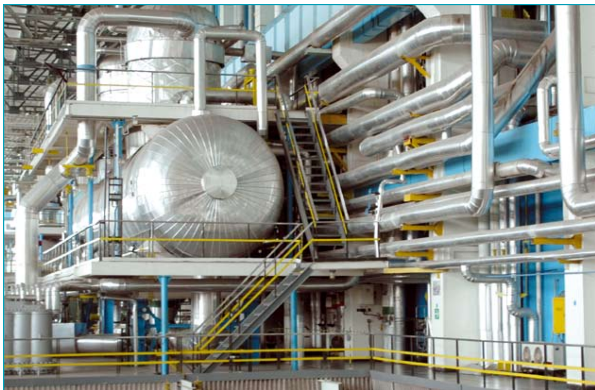
Машинната зала на първи - четвърти енергоблок
