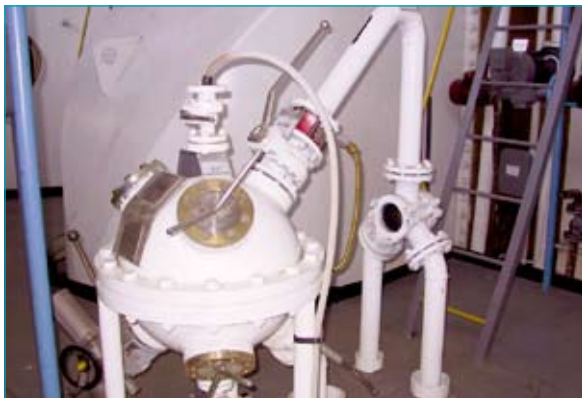
Топкоочиставаща инсталация на турбогенераторите на 3 и 4 блок
